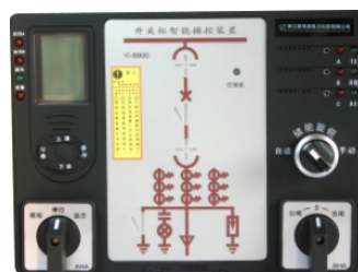
开关柜 智能操控装置
